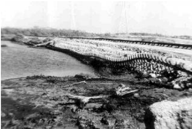
Fig. 20. Daños a la infraestructura por tsunami. Lázaro Cárdenas, México, 1985.
