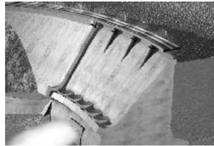
Figura 47. Algunas instalaciones, como las presas cuentan con redes locales de observación sísmica
