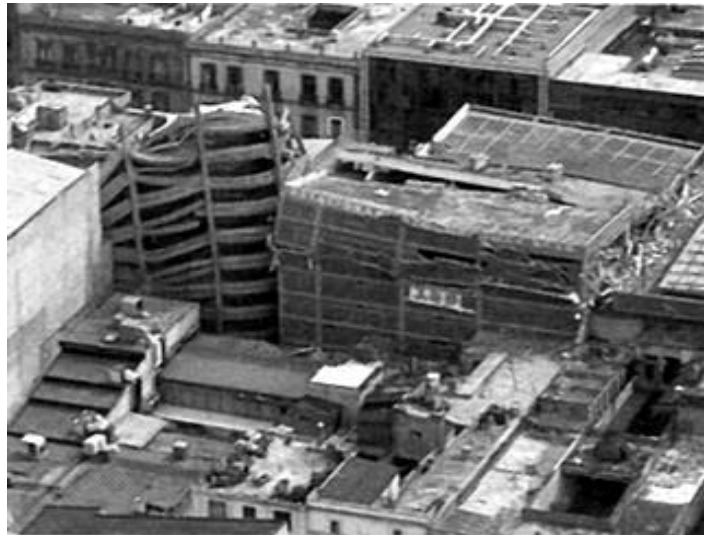
Figura 39. Estacionamiento derrumbado como un castillo de barajas también por falta de rigidez. Ciudad de México 1985
