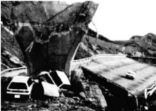
Figura 20. Colapso de un viaducto en Northridge, C.A., 1994.
