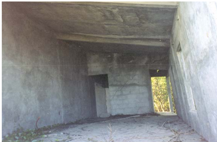
Figura 1.6 Falla por flexión del muro debido al giro de la cimentación en una estructura de mampostería confinada (H. Toledo; Huracán Pauline, Oaxaca, México, 1999)
