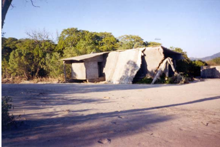
Figura 1.5 Falla de una estructura de mampostería confinada por efecto del viento en las costas del estado de Oaxaca (H. Toledo; Oaxaca, México, 1999)
