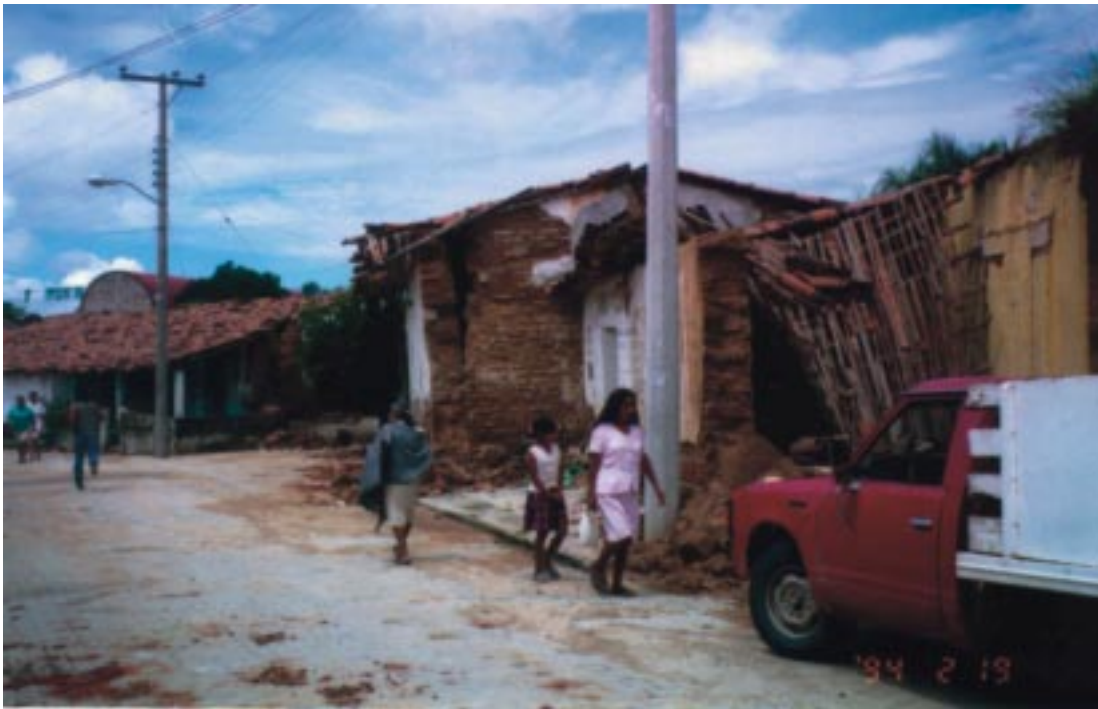
Figura 27. Daños típicos en construcciones de adobe
