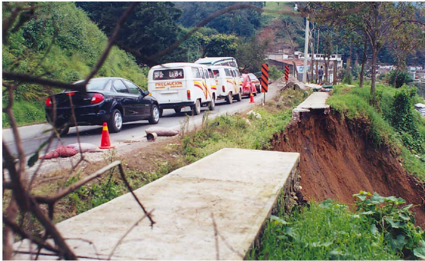
Figura 5.25 Deslizamiento contiguo a la carretera Perote-Teziutlán, en el tramo que cruza el barrio Xoloco
