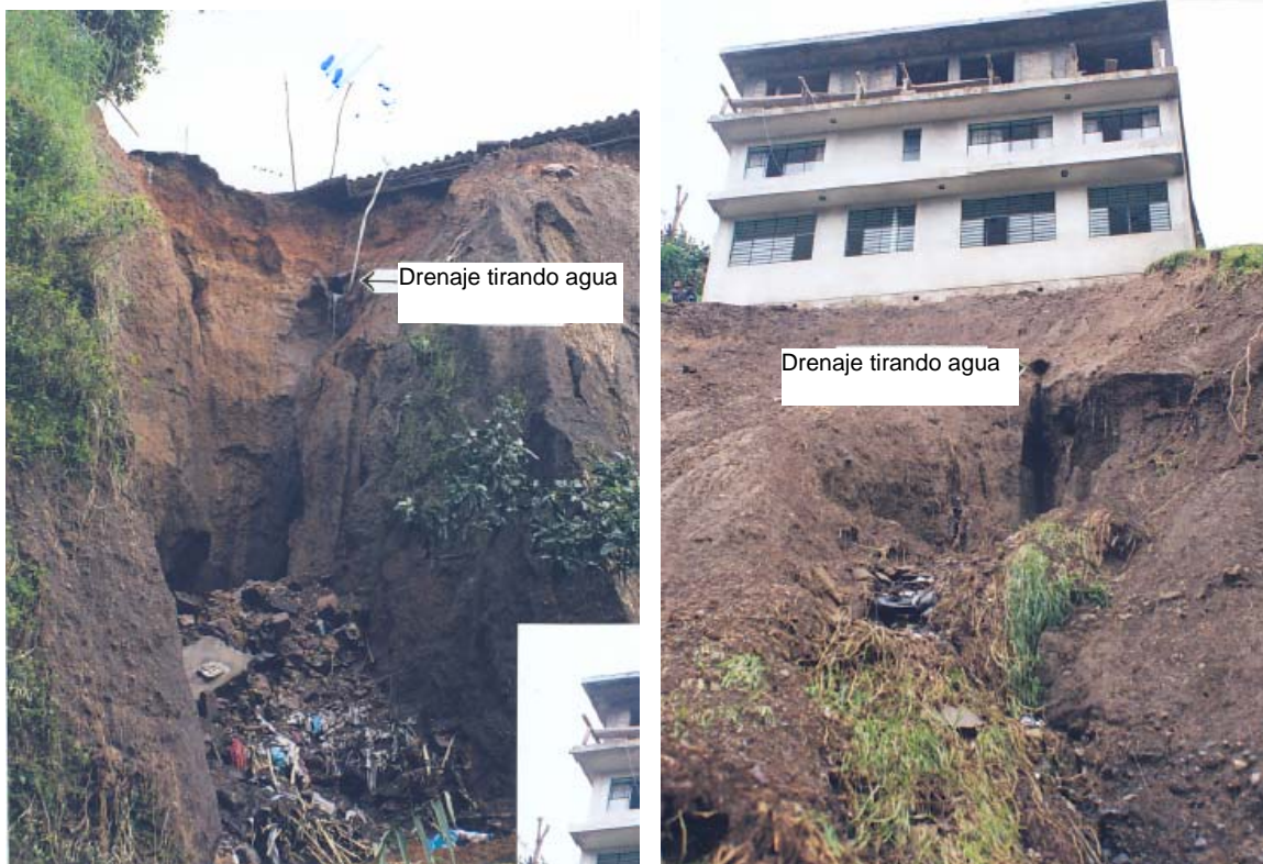
Figura 5.19 Deslizamientos de tierra provocados por fugas en los sistemas de drenaje
