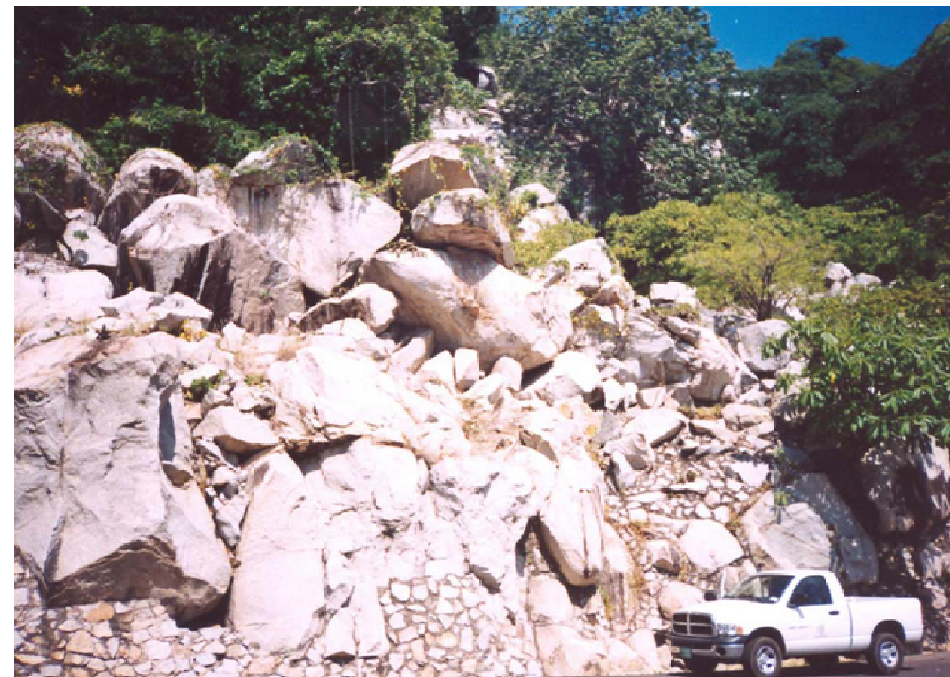
Figura 69. Fotografía de Zonas de peligro de caída de boques de la región de Punta Diamante. Nótese el tamaño de los bloques en comparación con el vehículo. Nótese también que la definición de la zona de bloques está en un corte de carretera en donde es muy fácil apreciar el tamaño de bloques, la disposición y la pendiente del terreno.
